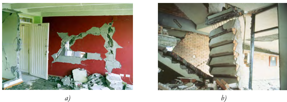
Figura 5.3. Daño en elementos no estructurales: a) Daño severo en muros divisorios, b) Daño fuerte en escaleras
