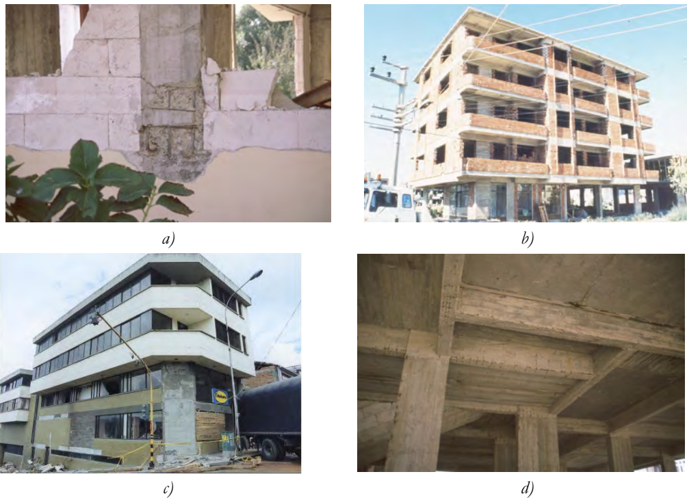
Figura 5.5. Condiciones preexistentes: a) Mala calidad en la construcción; b) Irregularidades verticales, piso blando; c) Irregularidades en planta; d) Mala configuración estructural: algunos elementos están fuera de los ejes principales
